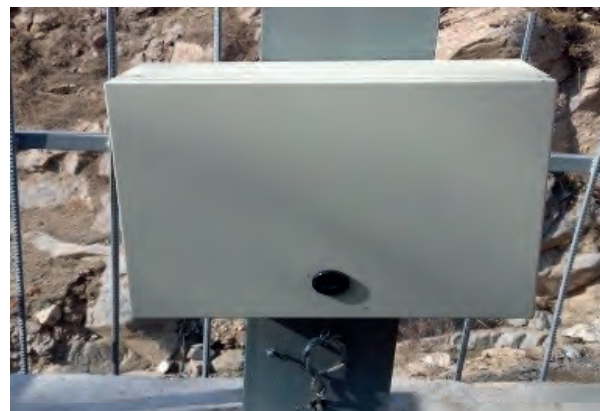
Сипари муҳофизии датчикҳои системаи IT-70 Защитный щит датчиков системы IT-70
