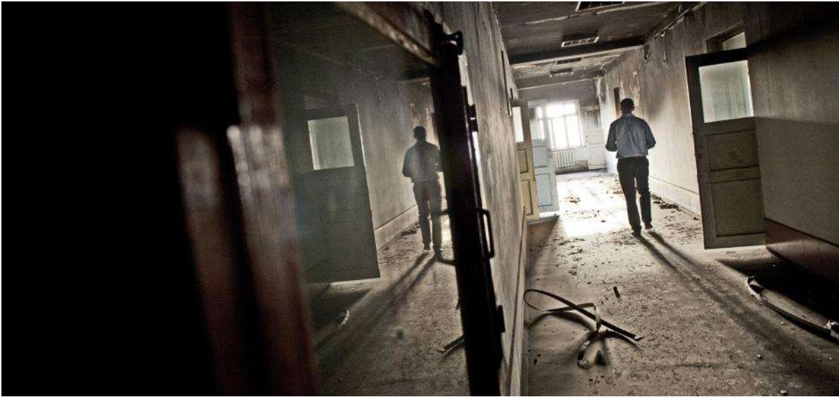
Am 12. Juni 2010 wurde im Zuge der Unruhen in Südkirgisistan die Kirgisisch-Usbekische Universität der Völkerfreundschaft in Dschalalabat geplündert und in Brand gesteckt. Auch im September 2014 bot die Universität noch immer ein Bild der Zerstörung.
